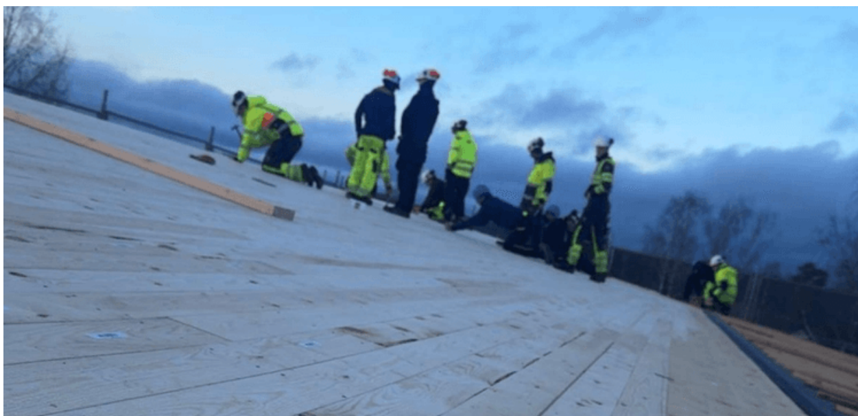
Elever fra Kjelle VGS i arbeid på taket, fra bygg- og anleggsteknikk og tømmerfaget
